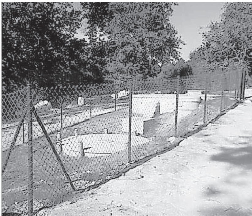
Una instalación de lecho bacteriano.
